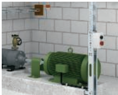
Монтаж стойки для подвода питания к электрооборудованию Соединение электроприводов со стойкой для подвода питания.
