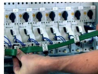
Надежная установка и электромонтаж
